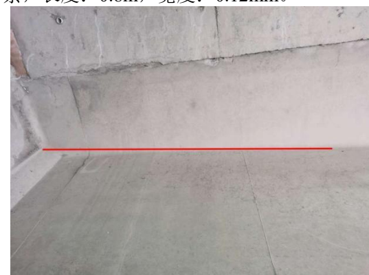
图 3-8: 湖洋 1 号大桥 (下行) 6-3T 梁: 距 6 号墩 0m 处, 左侧, 翼板与腹板交接处纵向裂缝; 数量: 1 条, 长度: 4m, 宽度: 0.12mm。
