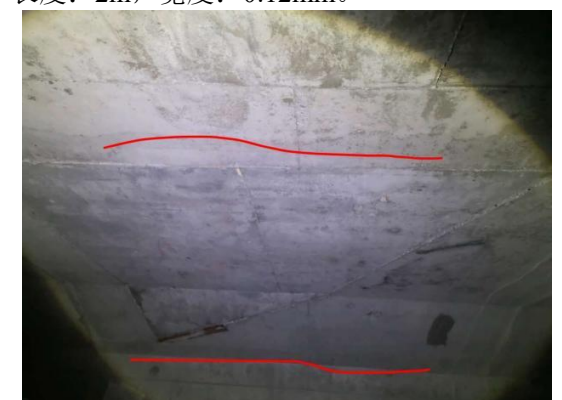
图 3-4：湖洋 1 号大桥（上行）7-7-11 箱梁：距右侧 0m 起，梁顶纵向裂缝；数量：2 条，最大长度：1.5m，最大宽度：0.12mm。
