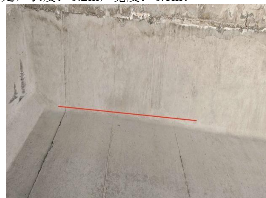
图 3-7: 湖洋 1 号大桥 (下行) 4-6T 梁: 距 3 号墩 0m 处, 右侧, 翼板与腹板交接处纵向裂缝; 数量: 1 条, 长度: 1.2m, 宽度: 0.12mm。
