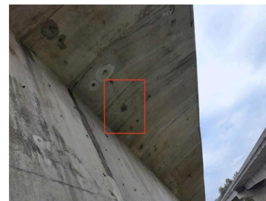
图 3-12: 湖洋 1 号大桥 (上行) 8-7-2 箱梁: 距左侧 2.5m 处, 左翼缘板露筋; 数量: 2 处, 最大长度: 0.2m。
