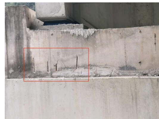
图 3-22: 湖洋 1 号大桥（上行）GR-9D 盖梁：距左侧 0.8m 起，小桩号面露筋；数量：4 处，最大长度：0.5m。
