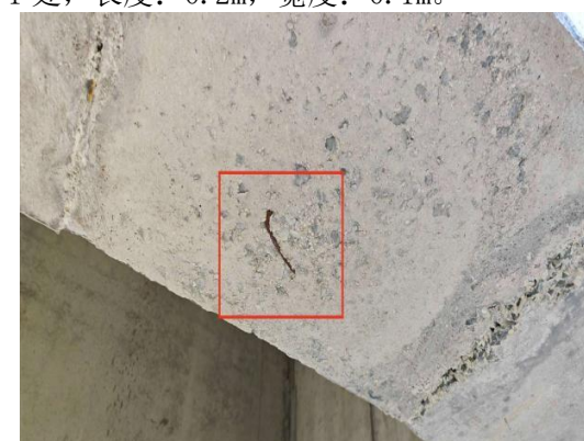
图 3-16: 湖洋 1 号大桥 (下行) 5-7T 梁: 距 4 号墩 0.5m 处, 梁底露筋; 数量: 1 处, 长度: 0.2m。
