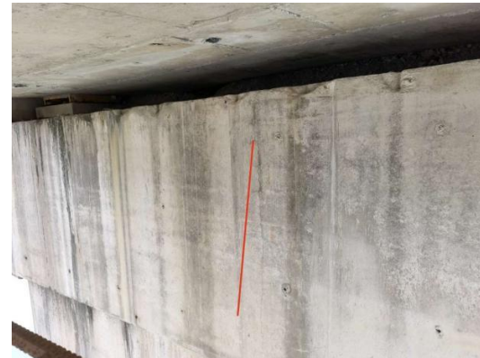
图 3-17: 湖洋 1 号大桥（上行）GR-6D 盖梁：距右侧 2.0m 起，大桩号面竖向裂缝；数量：5 条，最大长度：0.02m，最大宽度：0.12mm。
