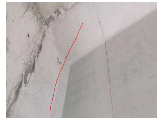
图 3-1：湖洋 1 号大桥（上行）4-7T 梁：距 3 号墩 0m 处，右翼缘板斜向裂缝；数量：1 条，长度：1.3m，宽度：0.13mm。
