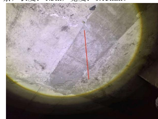
图 3-3：湖洋 1 号大桥（上行）7-7-10 箱梁：距左侧 2.5m 处，梁顶斜向裂缝；数量：1 条，长度：1m，宽度：0.12mm。
