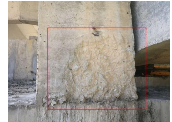
图 3-26: 湖洋 1 号大桥（下行）GL-9D 盖梁：左侧挡块剥落、露筋；数量：1 处，长度：0.5m，宽度：0.5m。
