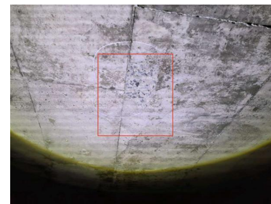
图 3-11: 湖洋 1 号大桥 (上行) 7-7-11 箱梁: 距左侧 3m 处, 梁顶剥落、掉角; 数量: 1 处, 长度: 0.2m, 宽度: 0.2m。
