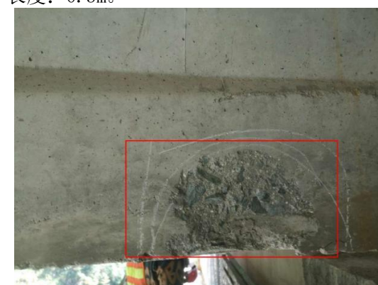
图 3-15: 湖洋 1 号大桥 (下行) 6-5T 梁: 距 6 号墩 1m 处, 马蹄右侧面剥落、掉角; 数量: 1 处, 长度: 0.15m, 宽度: 0.15m。
