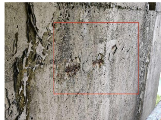
图 3-21: 湖洋 1 号大桥（上行）GR-3D 盖梁：距右侧 1m 处，距上缘 0.2m 处，小桩号
