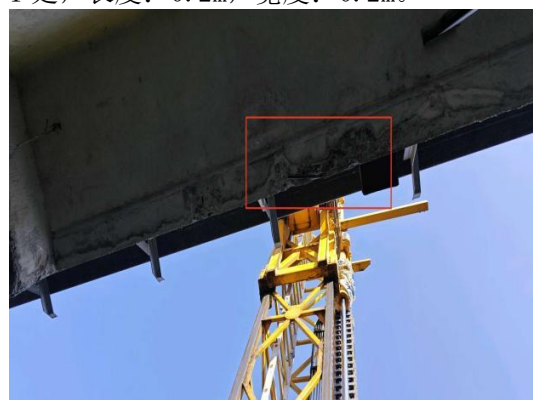
图 3-13: 湖洋 1 号大桥 (下行) 4-7T 梁: 距 3 号墩 1m 处, 左翼缘板露筋; 数量: 1 处, 长度: 0.3m。
