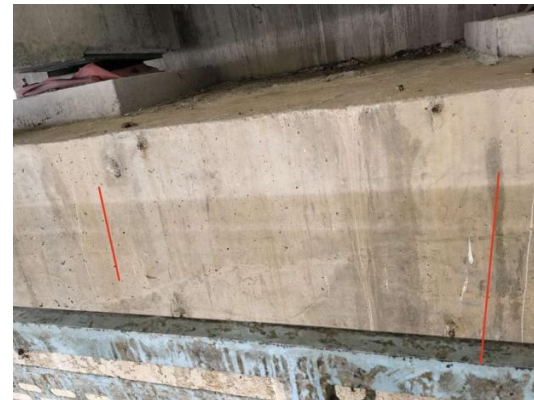
图 3-19: 湖洋 1 号大桥（下行）GL-9D 盖梁：距右侧 1.5m 起，大桩号面竖向裂缝；数量：4 条，最大长度：0.6m，最大宽度：0.12mm。
