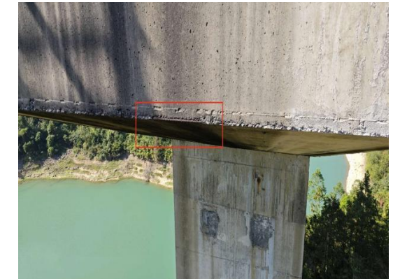
图 3-24: 湖洋 1 号大桥（下行）GL-6D 盖梁：左侧露筋；数量：3 处，最大长度：0.5m。
