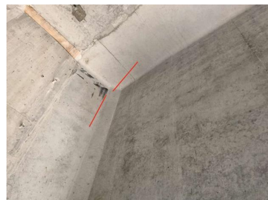
图 3-5: 湖洋 1 号大桥 (下行) 2-7T 梁: 距 1 号墩 0m 处, 左翼缘板剥落、掉角; 数量: 1 处, 长度: 0.2m, 宽度: 0.1m。
