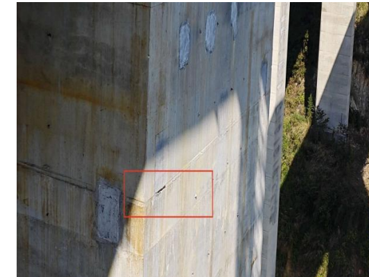
图 3-25: 湖洋 1 号大桥（下行）DS-8-1D 墩身：距大桩号面 0.3m 处，距上缘 2m 处，左侧露筋；数量：1 处，长度：0.3m。
