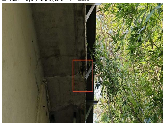
图 3-14: 湖洋 1 号大桥 (下行) 2-7T 梁: 距 1 号墩 0m 处, 左翼缘板剥落、掉角; 数量: 1 处, 长度: 0.2m, 宽度: 0.1m。
