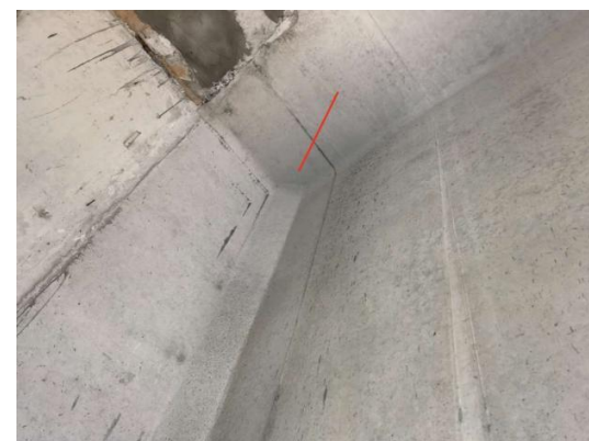
图 3-6: 湖洋 1 号大桥 (下行) 4-4T 梁: 距 3 号墩 0m 处, 左翼缘板斜向裂缝; 数量: 1 条, 长度: 0.8m, 宽度: 0.12mm。
