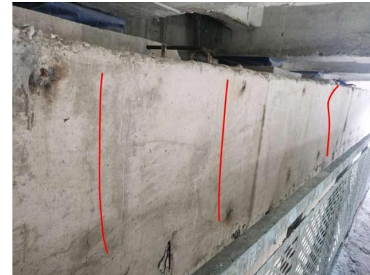
图 3-18: 湖洋 1 号大桥（上行）GR-9D 盖梁：距左侧 1.8m 起，大桩号面竖向裂缝；数量：7 条，最大长度：0.02m，最大宽度：0.13mm。
