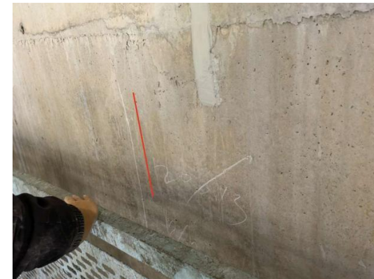
图 3-20: 湖洋 1 号大桥（下行）GL-6D 盖梁：距右侧 2m 起，小桩号面竖向裂缝；数量：10 条，最大长度：2m，最大宽度：0.13mm。
