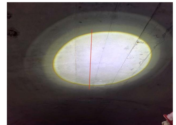
图 3-2：湖洋 1 号大桥（上行）7-7-9 箱梁：距左侧 3m 处，梁顶纵向裂缝；数量：1 条，长度：2m，宽度：0.12mm。
